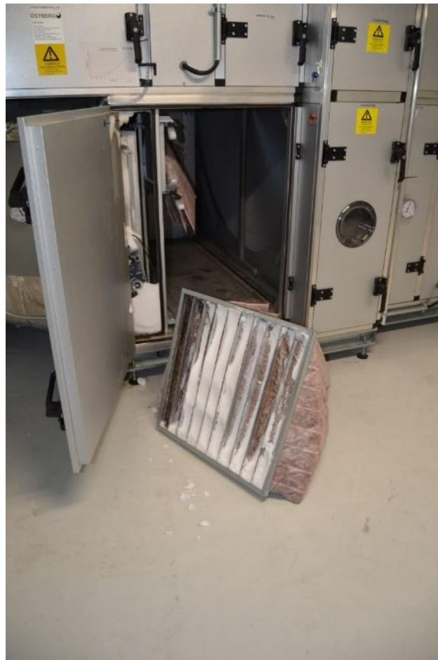
Lunta pääsee haitallisessa määrin tuloilmakoneeseen
