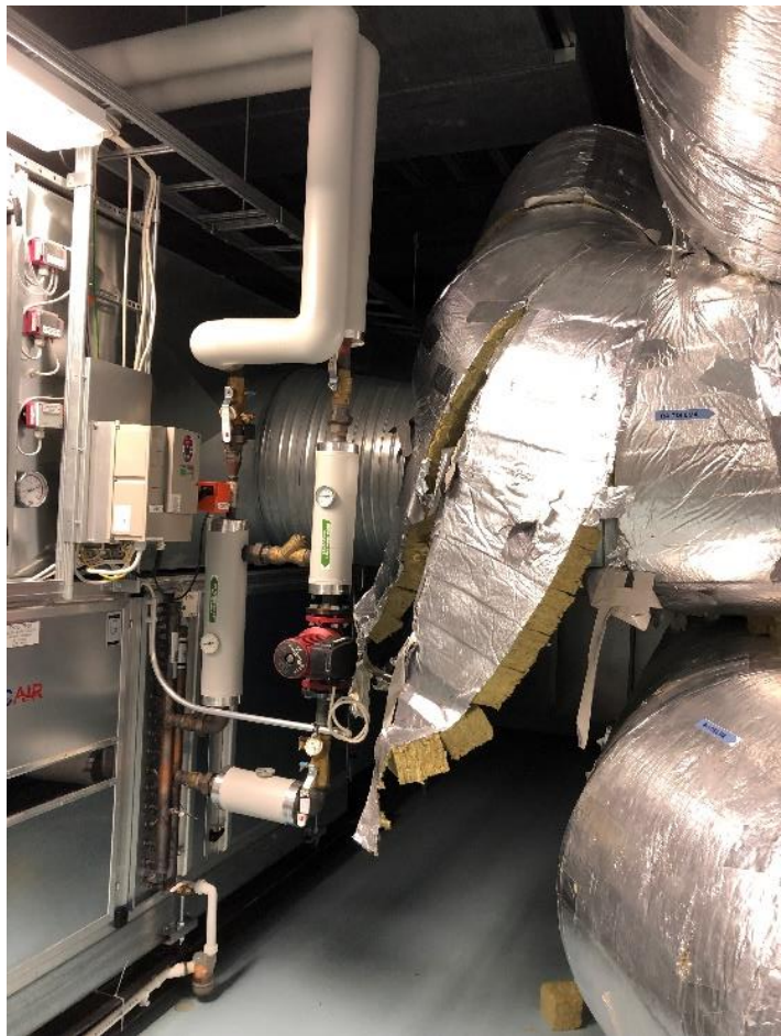
Tuloilmakanavan lämmöneriste on irronnut kiinnityksestään
