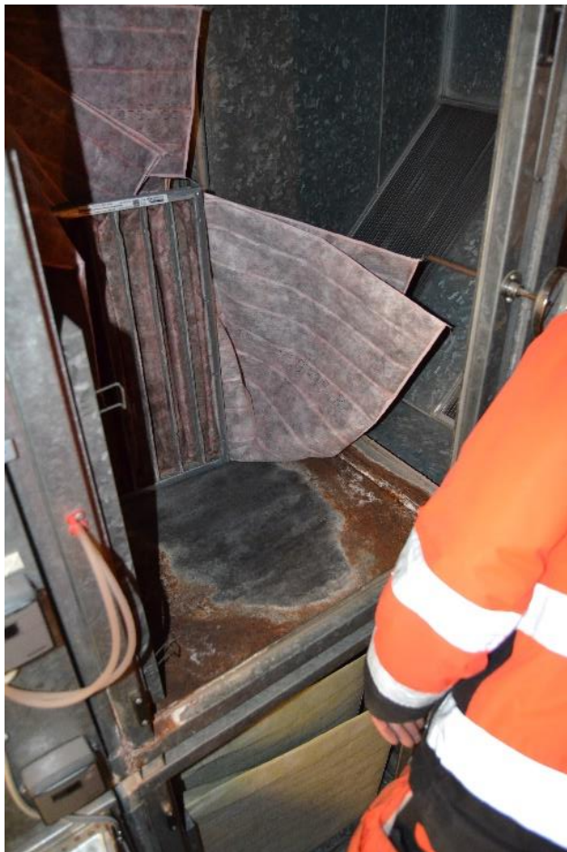
Suodatinkammion pohjapelti on läpiruostunut
