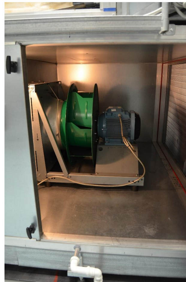
Puhallin ei pysähdy automaation ohjauksesta
